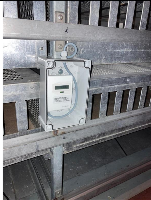
CO 2 sensor ingebouwd in een plastic behuizing, zodat die afgedekt kan worden bij reiniging van de wagen (de sensor kan niet tegen water)
