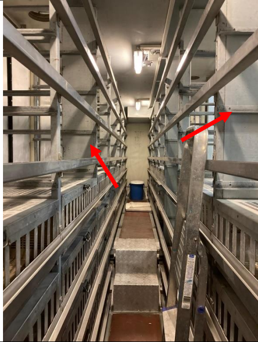
Overzicht gang pad wagen met de ventilatiekokers (om en om // rechts en links om de twee kolommen)
